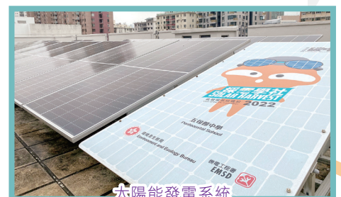
太陽能發電系統
